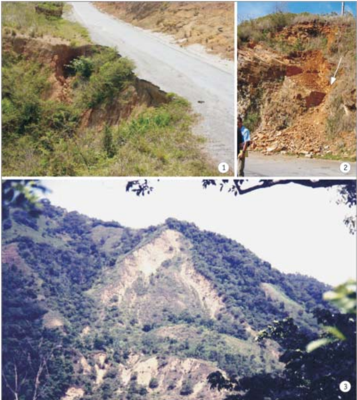
Fig. 7.11: Deslizamientos de laderas: 1. y 2. (Carretera de Montaña, Pinar del Río). 3. (Cordillera Septentrional, República Dominicana).
