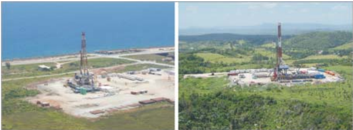
Fig. 11.6: Dos estaciones de perforación para petróleo y gas (región norte de La Habana y Matanzas). La que se encuentra en el litoral realiza pozos inclinados hacia el mar, a fin de explotar los recursos que yacen en la plataforma insular.
