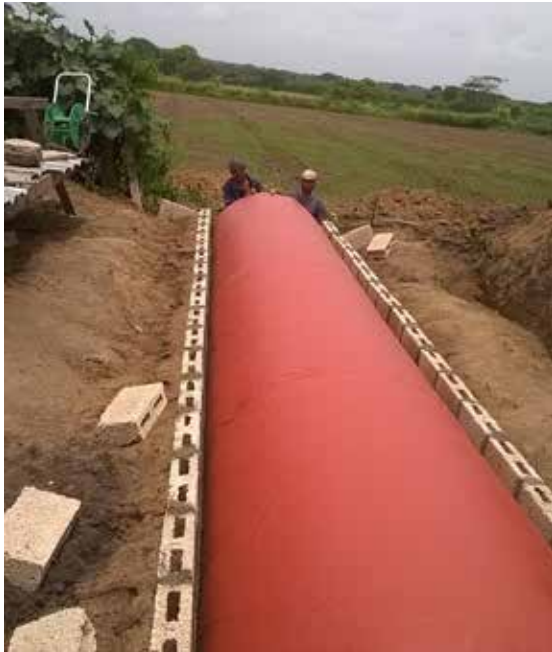
Biodigestor tubular de membrana
